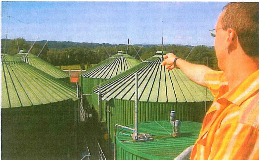
Herr der Behälter: Geschäftsführer Gernot Breitenhuber zeigt über die mit einem Blitzschutz versehene Stahlfermenter und Lagerbehälter der Murecker Biogasanlage. Fotos: Dany (3)/Rohn (2)
